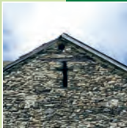
Kreuz als Lüftungsschlitze , Hospental
