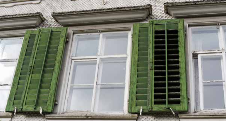
Anlass und Auslöser für das Projekt waren die alten, undichten Fenster. Foto: bm architekten eth sia
